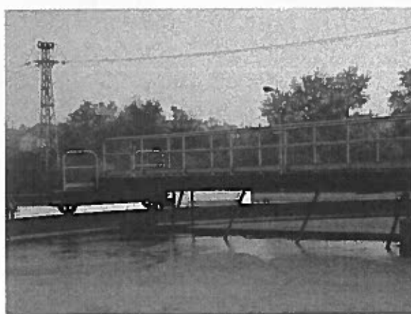
Sistema de raspagem de superfície no decantador secundário
