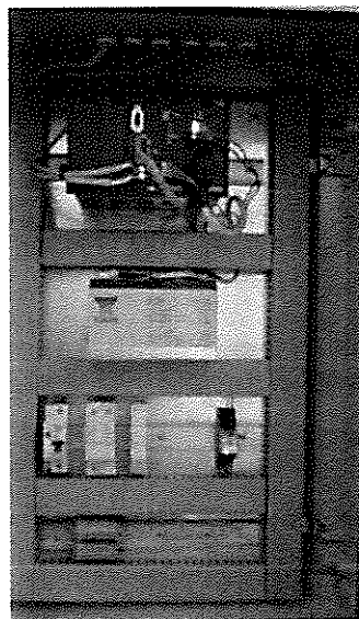
Quadro de Telegestão do Reservatório Alto de Vilar
