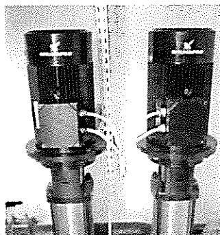
Bombas da Central Elevatória da Fontinha
