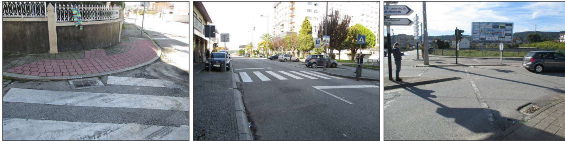
Figura 38. Exemplos de ausência e má execução dos rebaixamentos a obstruir o percurso acessível
