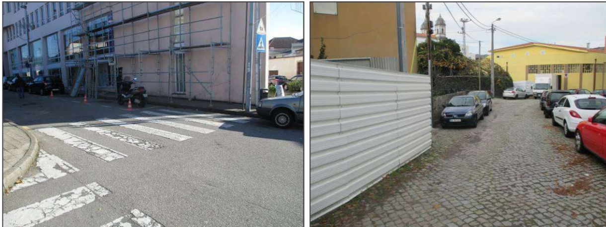
Figura 45. Exemplo de obra ou tapume de obra a obstruir o percurso acessível
