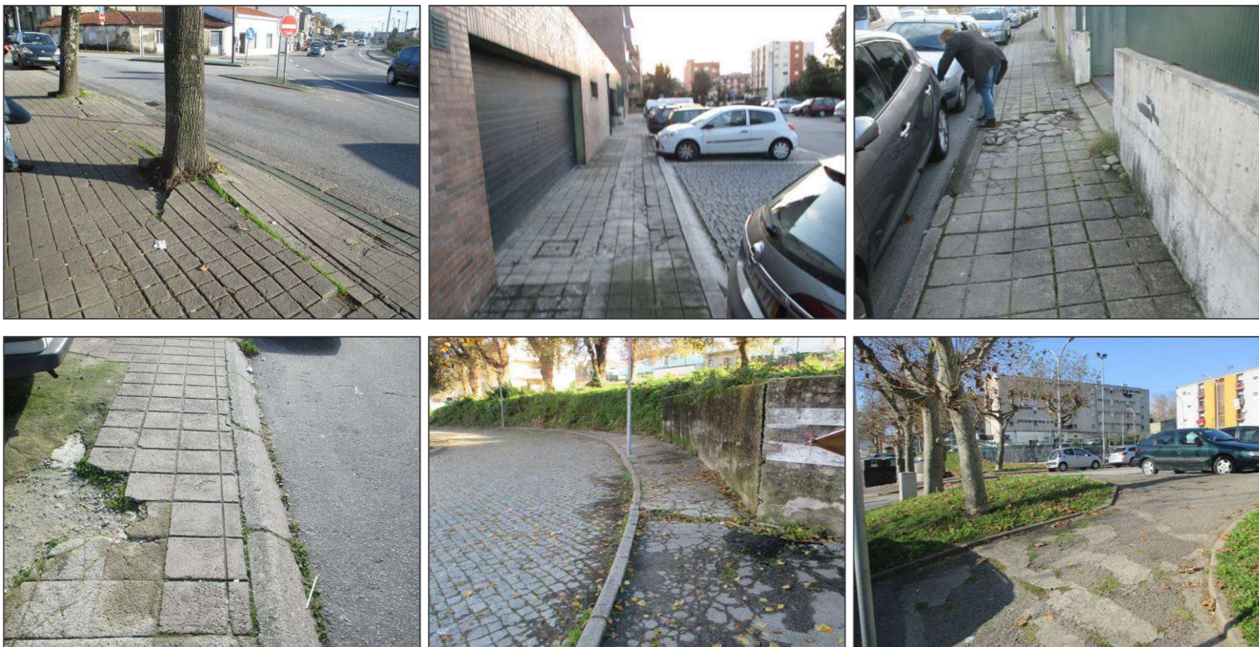
Figura 42. Exemplos pavimento degradado a obstruir o percurso acessível
