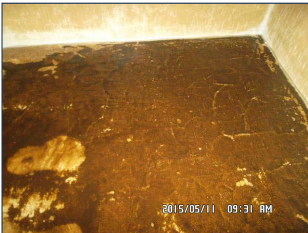
RUA LAMEIRA ANTES DA LIMPEZA E DESINFECÇÃO
