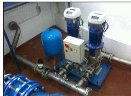
Central de pressurização da Estrada Velha.
